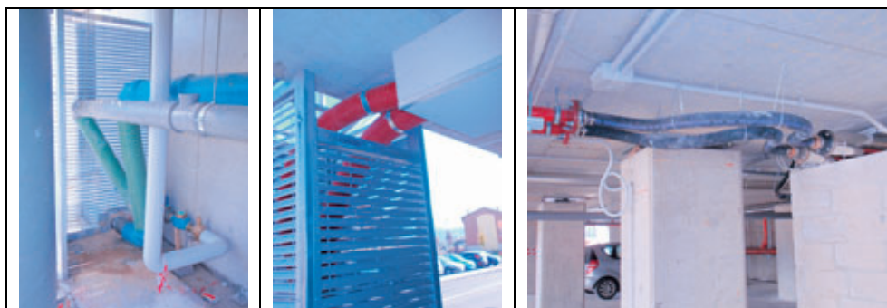
Fig. 6 – Esempi di connessioni impiantistiche flessibili negli edifici con isolamento sismico del Progetto C.A.S.E. a L'Aquila, all'interfaccia tra parti isolate e non isolate.
