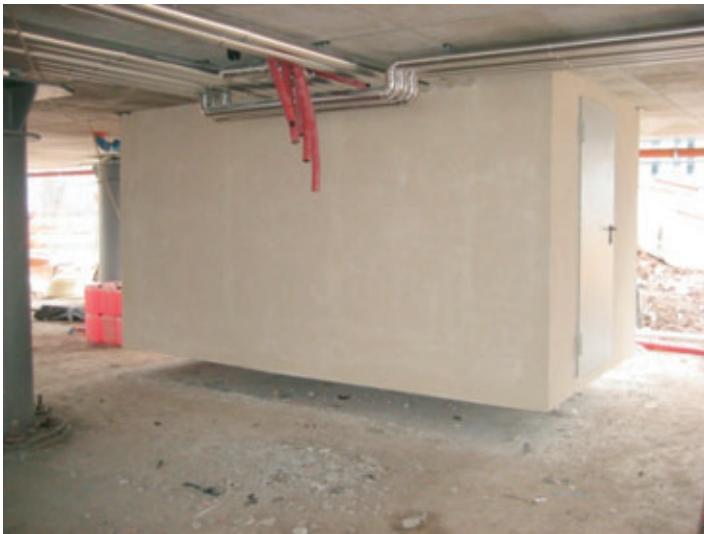
Figura 47 – Sottocentrale sospesa e solidale con la piastra antisismica “Cosbau SpA”.
