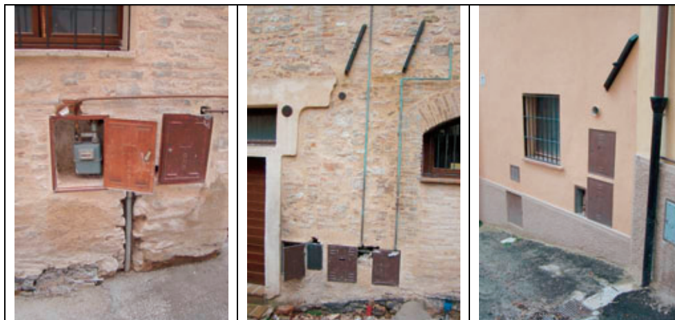
Fig. 11 – Esempi di profonde incisioni e conseguenti indebolimenti dei maschi murari di edifici in muratura sottoposti a interventi di miglioramento sismico.
