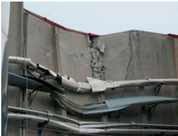
Figura 9 - Potenziali criticità associate all'interazione con altri elementi. Schiacciamento delle condutture impiantistiche per effetto di martellamento dell'involucro di un silos contro la parete perimetrale. Terremoto de L'Aquila 2009.
