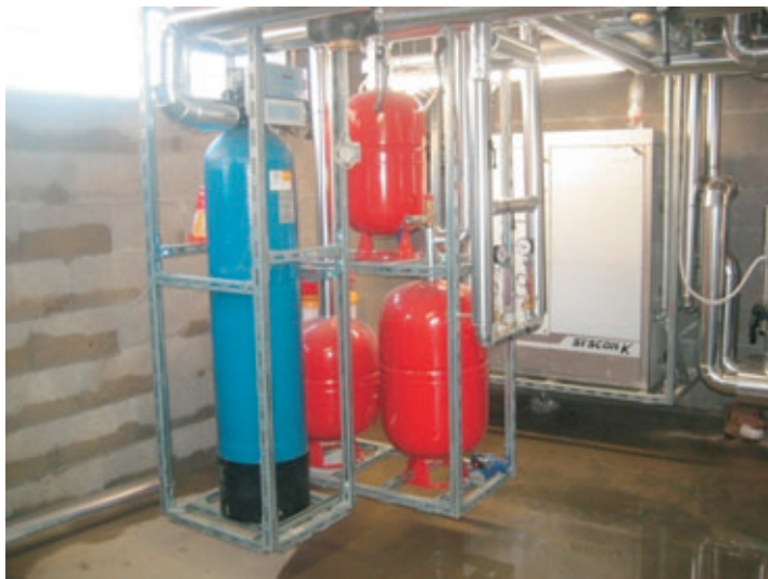
Figura 48 – Apparecchiature della sottocentrale sospese a soffitto dell'autorimessa "RTI Eschilo".
