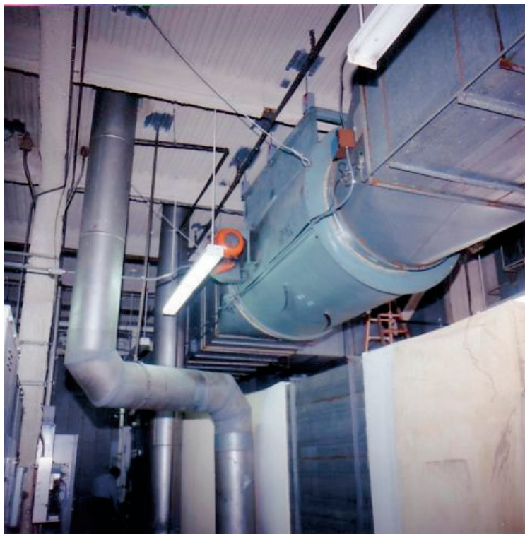
Figura 8 – Sospensione antisismica di ventilatore assiale
