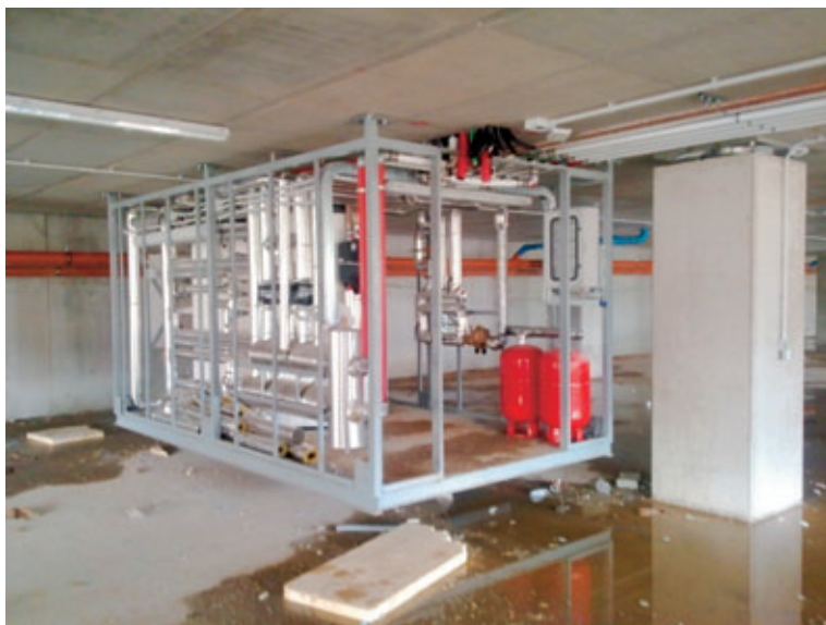
Figura 44 – Sottocentrale sospesa e solidale con la piastra antisismica “Cosbau SpA”.
