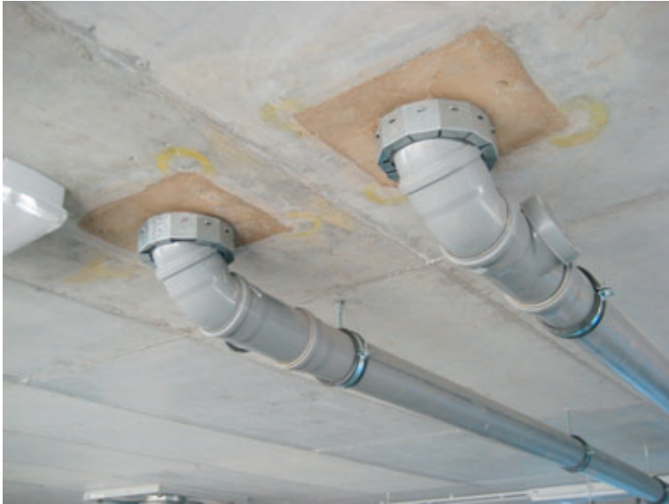
Figura 37 – Collari antincendio per tubazione di scarico passanti a soffitto del piano autorimessa.
