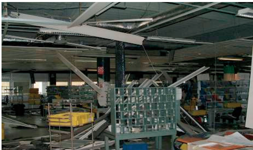
Figura 1 – Danni agli elementi non strutturali al Centro Operativo delle Poste Italiane a seguito del terremoto de L'Aquila 2009.
