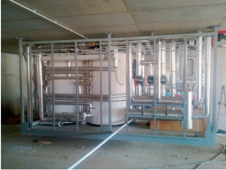
Figura 46 – Sottocentrale sospesa e solidale con la piastra antisismica “Cosbau SpA”.
