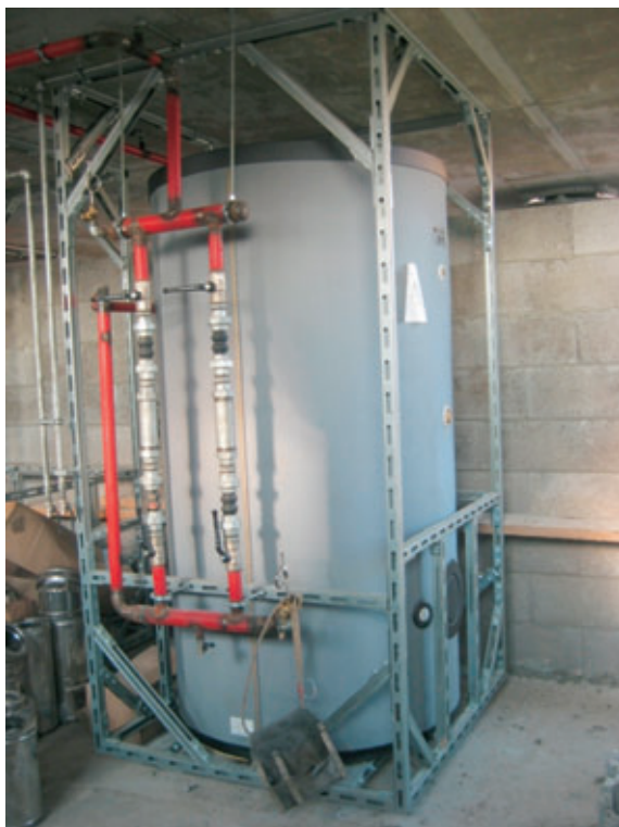
Figura 49 – Apparecchiature della sottocentrale sospese a soffitto dell'autorimessa "RTI Eschilo".
