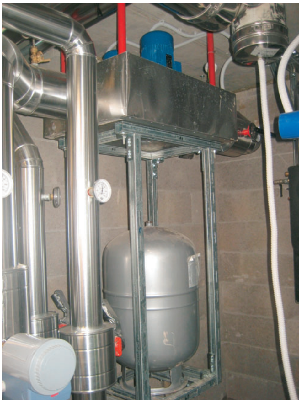
Figura 50 – Apparecchiature della sottocentrale sospese a soffitto dell'autorimessa "RTI Eschilo".
