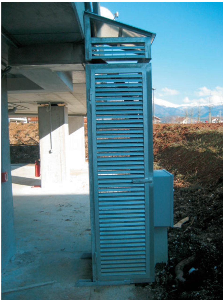
Figura 19 – Giunto sismico per il collegamento ENEL.
