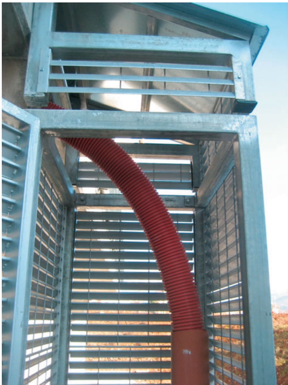
Figura 21 – Giunto sismico per il collegamento ENEL.
