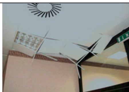
Fig. 8 – Crollo di controsoffitti moderni e degli apparecchi di illuminazione – terremoto Abruzzo 2009.
