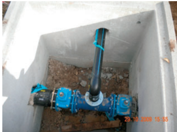
Figura 10 – Pozzetto acquedotto, foto.
