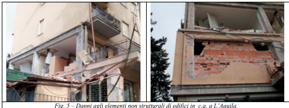
Fig. 5 – Danni agli elementi non strutturali di edifici in c.a. a L'Aquila.
