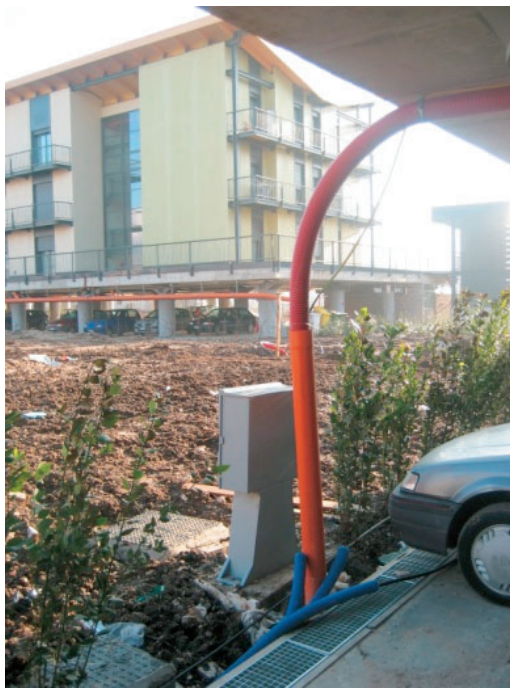
Figura 17 – Cavidotto Enel e contenitore.
