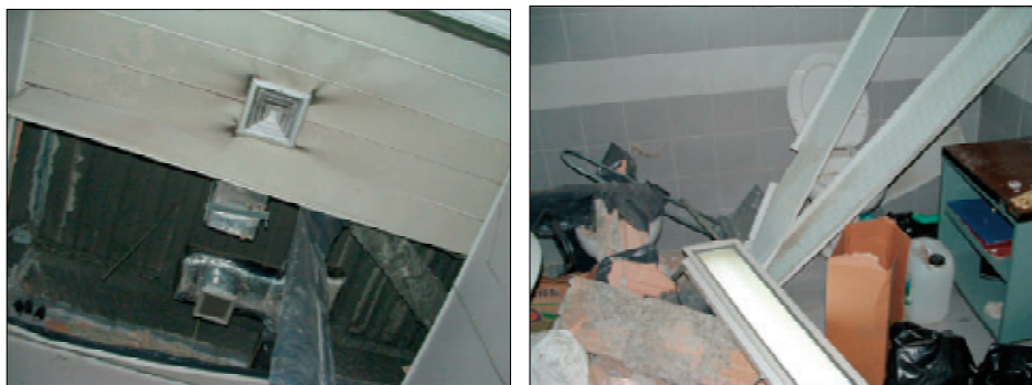
Figura 5 – Effetti dell'interazione tra componenti impiantistici ed altri componenti costruttivi non strutturali. Vista del soffitto (foto a destra). Elementi di controsoffittatura, di partizioni in mattoni forati e lampade crollati (foto a sinistra). Centro operativo delle Poste Italiane L'Aquila. Terremoto de L'Aquila 2009.
