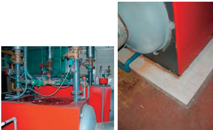
Figura 12 – Perdita d'acqua dalle tubazioni sopra la caldaia (foto a sinistra). Scorrimento della caldaia sul basamento e distacco della condotta dei fumi dalla caldaia (foto a destra). Centro operativo delle Poste Italiane L'Aquila. Terremoto de L'Aquila 2009.
